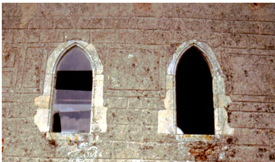
Le Désert, chapelle Saint-Ortaire, vue de l'enduit du XVII e siècle avant sa destruction
