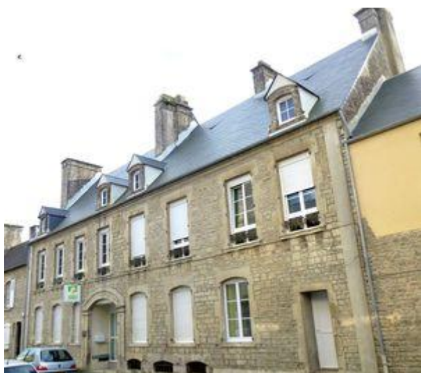
Façade principale sur rue, malheureusement privée de son enduit
